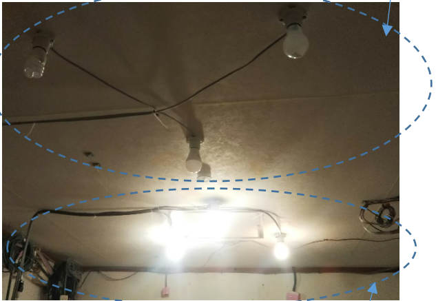
図 I - 2 : 照明 (天井に設置)
